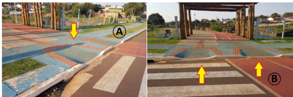
Figura 15: Calçadas com piso podotátil correto na zona C.
