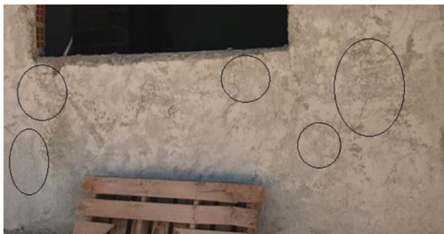
Figura 10. Detalhe das fissuras verificadas
